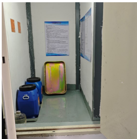
图 3-4q 危险废物暂存间
