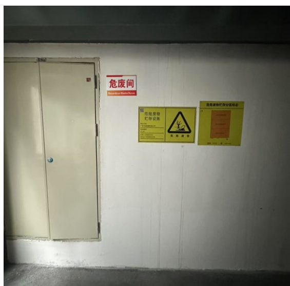
图 3-4p 危险废物暂存间
