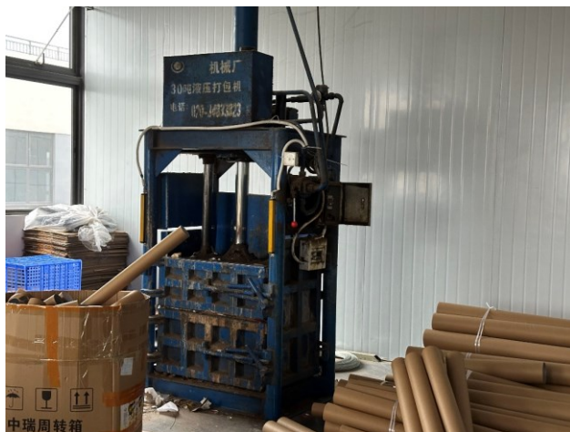
图 3-4m 压纸机及一般固废暂存间
