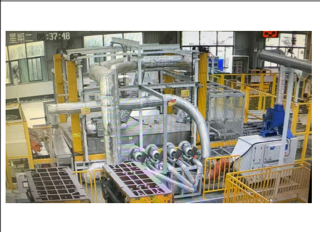
监控画面（加热脱脂设备和主要治理设施）
