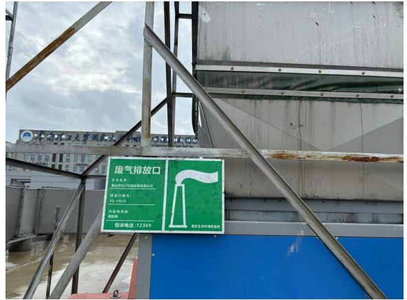
打磨粉尘废气排放口标识牌
