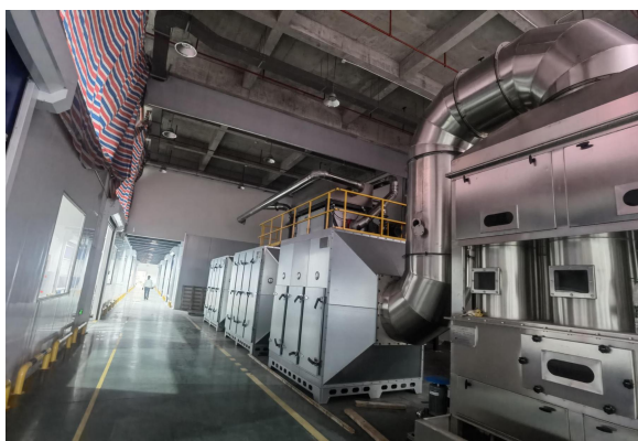
喷粉固化有机废气处理设施
