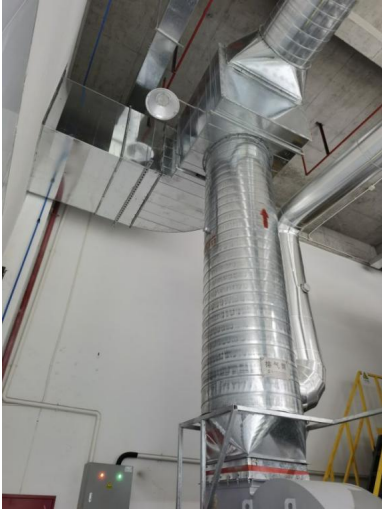
喷漆废气废气处理设施排气筒
