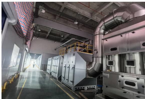
喷粉固化有机废气处理设施
