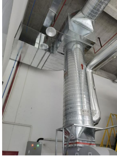
喷漆废气废气处理设施排气筒
