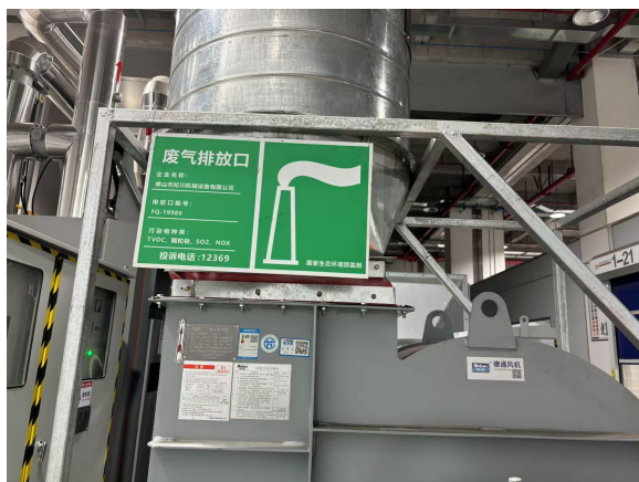
喷粉固化有机废气排放口标识牌
