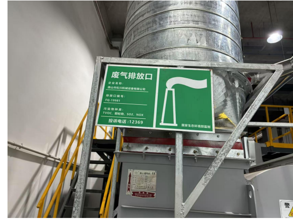
喷漆废气废气排放口标识牌
