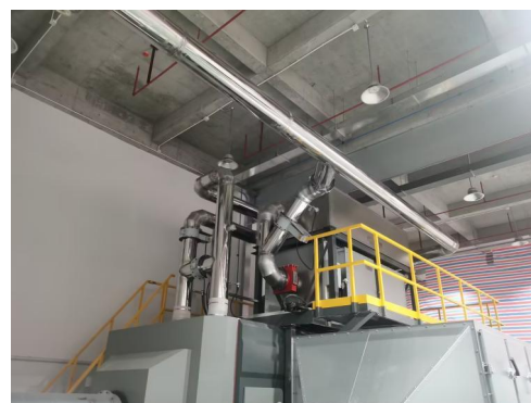
喷漆废气废气处理设施
