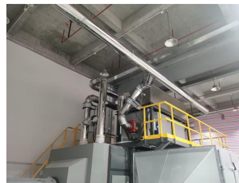
喷漆废气废气处理设施
