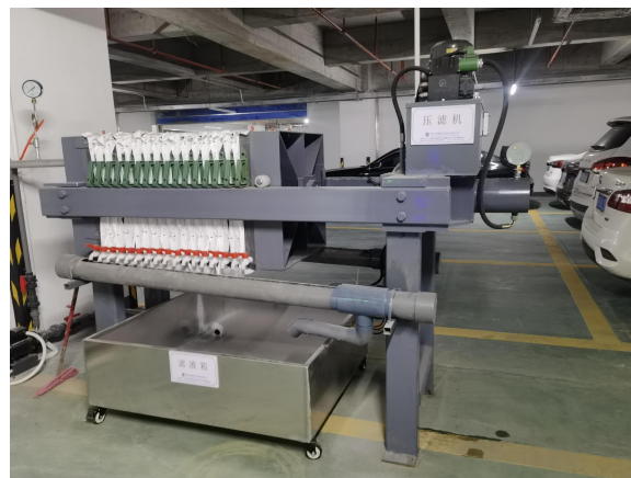
不锈钢前处理废水处理设施-压滤机
