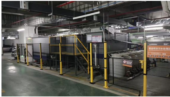
碳钢前处理废水处理设施
