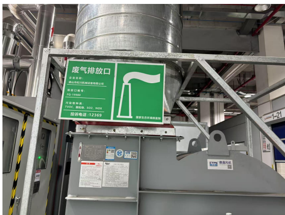
喷粉固化有机废气排放口标识牌
