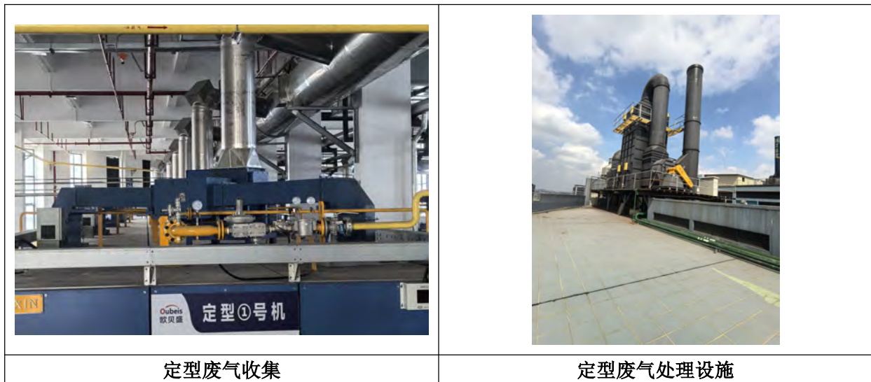
图 5-2 项目废气治理设施现场图
