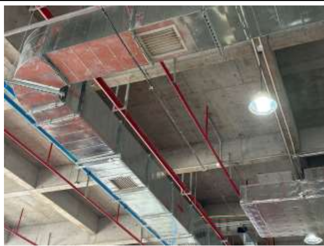
图 3-10j 厂房三层家禽交易区废气收集管道
