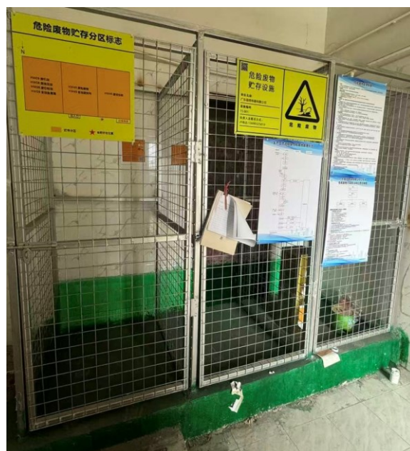
图 3-4o 危险废物暂存间
