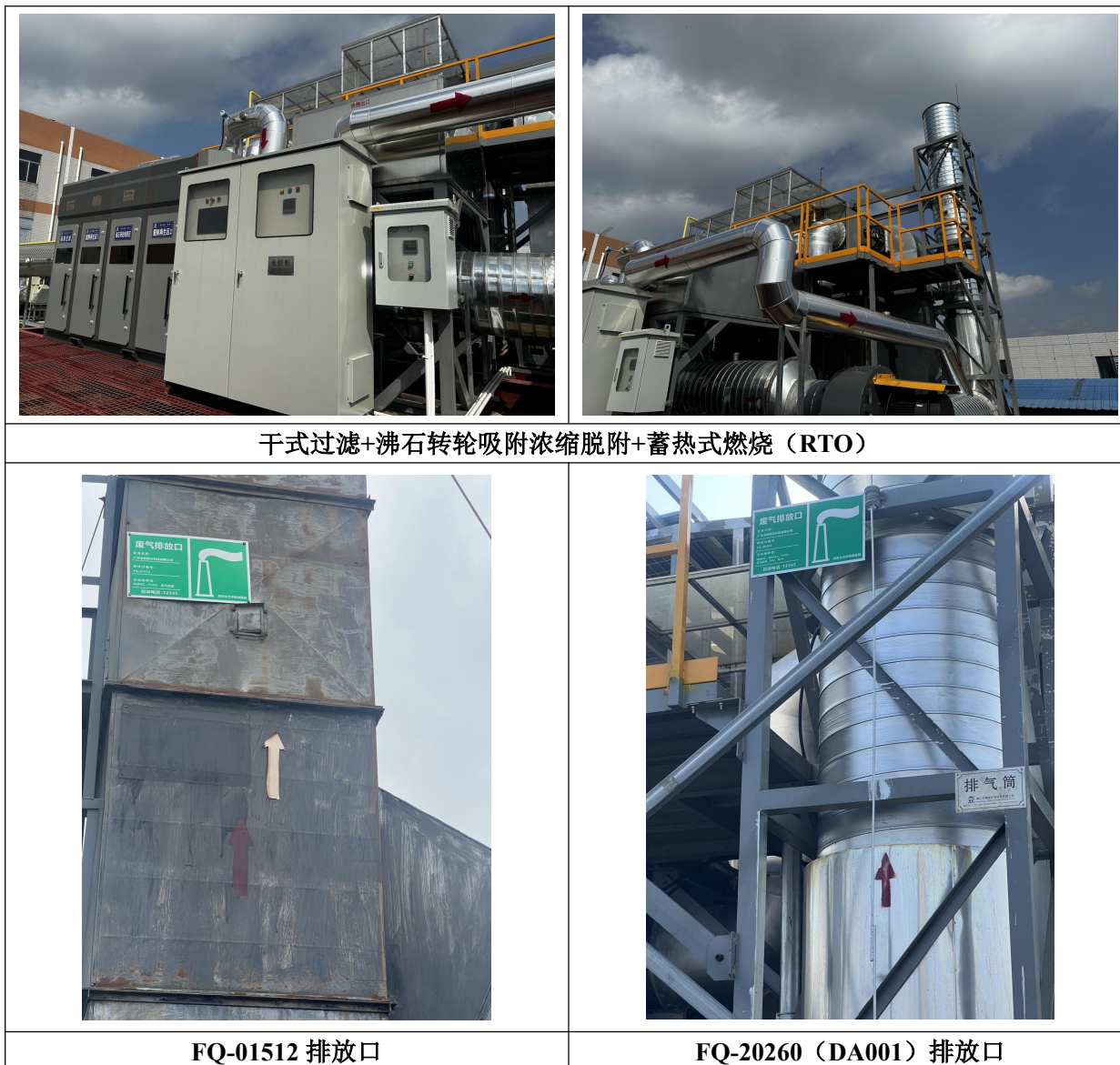
图 5-4 项目废气治理设施现场图
