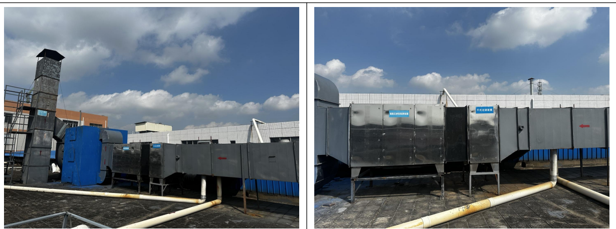
干式过滤+活性炭吸附装置
