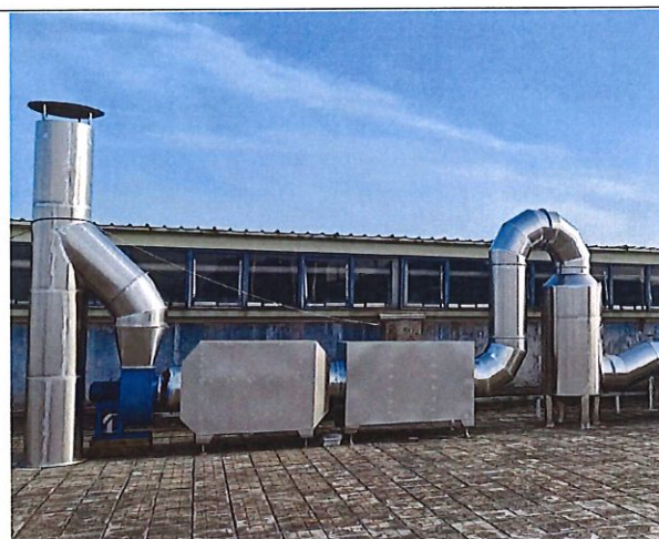
图 5-7 脱脂烘干废气处理设施（冷凝+活性炭吸附）
