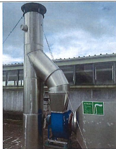
图 5-8 脱脂烘干废气排放口（气-FQ-20597）
